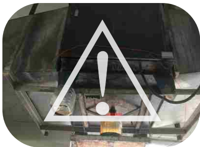
排油系统有漏油现象
